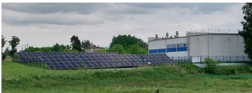
Rys. 3 Instalacja PV na terenie Stacji Uzdatniania Wody przy ul. Rajskiej
