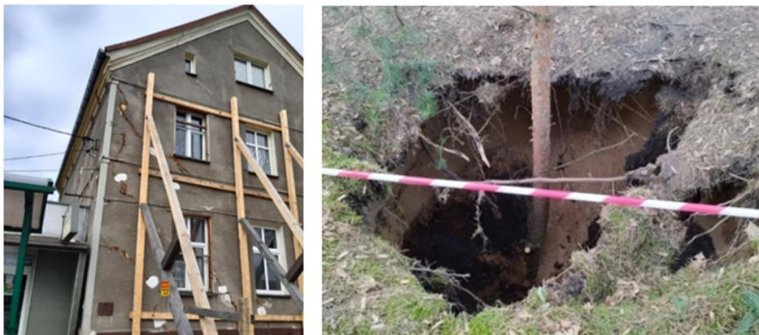
Rys. 1a Przykład uszkodzeń budynku, 1b Przykład zapadliska na terenie pogórnicyz
