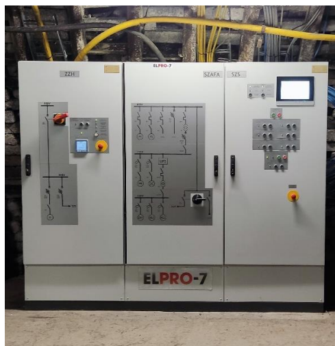
Rys. 3 Zespół regulacyjno-sterujący hydrogeneratora w Pompowni Stacjonarnej „Boże Dary”
