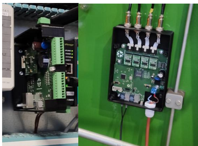
Rys. 4 Moduł nadrzędny z widoczną wewnątrz elektroniką zainstalowany w szafie sterowniczej (z lewej) i moduł podrzędny zainstalowany na stojaku hamulcowym (z prawej)
